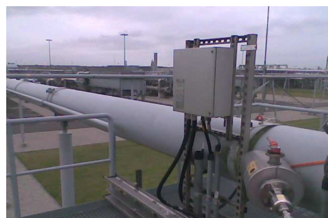
Installatie van een Flare Gas Flow meter
