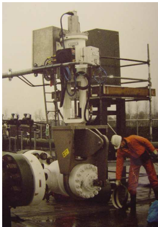
Service engineer bij een control valve op een NAM locatie
